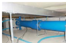
飲料水貯留システム
