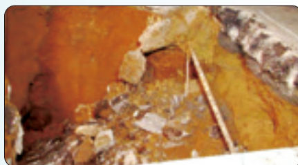
下水管の破損による道路陥没
