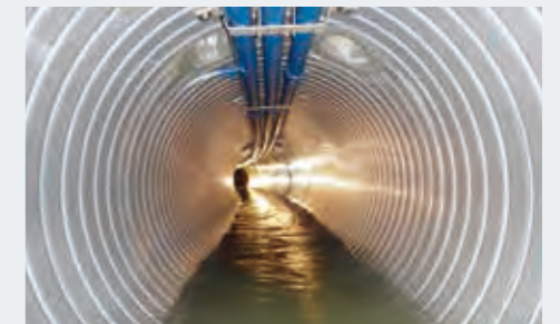
エスロヒート下水熱施工後の下水道管
