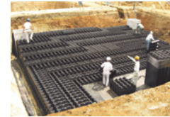
豪雨対策に貢献する雨水貯留槽
