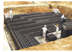
豪雨対策に貢献する雨水貯留槽
