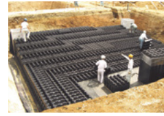
豪雨対策に貢献する雨水貯留槽
