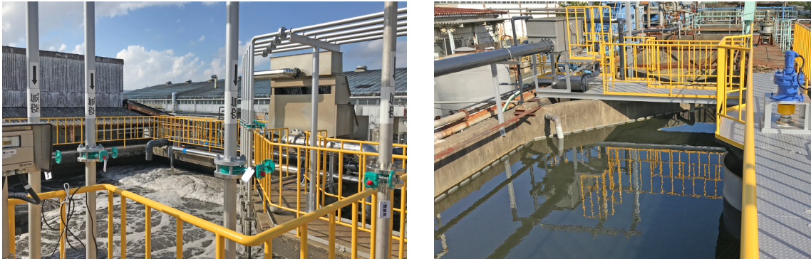
日本 事業拠点2の排水処理設備
